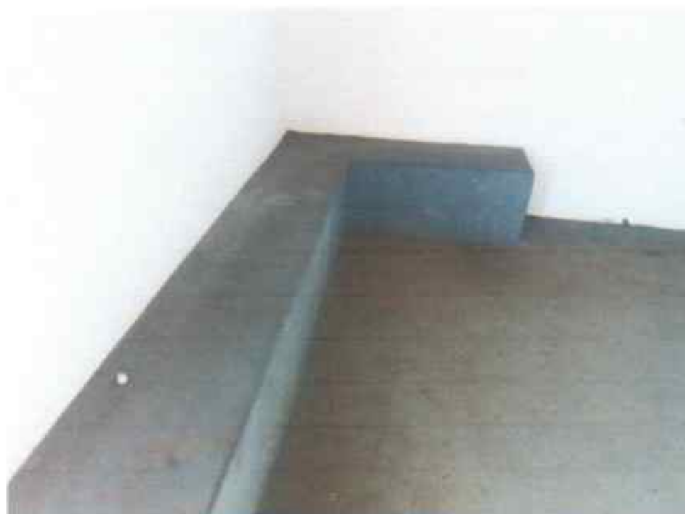
FOTO 12 – BANCO DO VESTIÁRIO DOS ÁRBITROS
