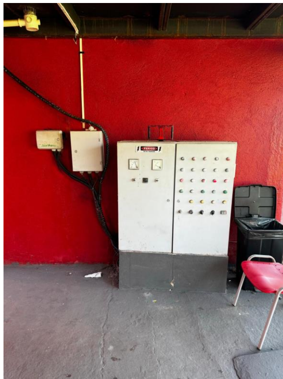
Figura 8: QUADRO ELÉTRICO ADMINISTRAÇÃO/SISTEMA DE BOMBAS
