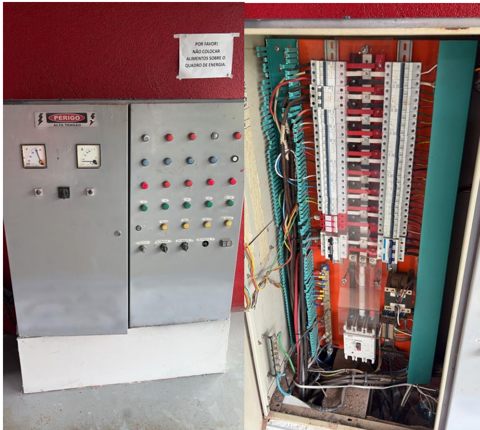
Figura 36: Quadro de Distribuição Geral
